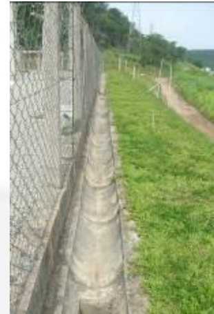
Foto 06. Canaleta para águas pluviais
