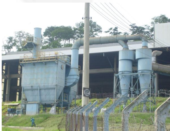
Foto 03. Sistema de limpeza de gases
