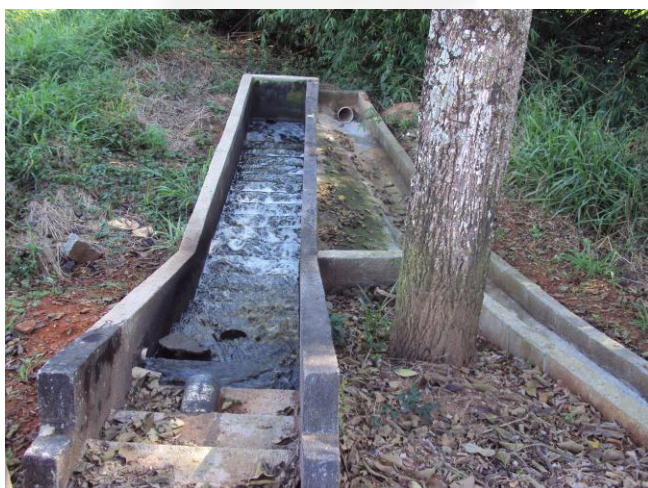
- Lançamento do efluente com escada de aeração
