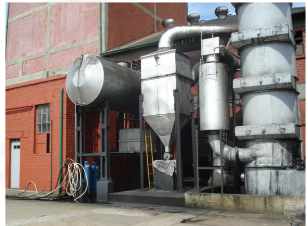
FOTO 02. Lavador de Gases das Caldeiras
