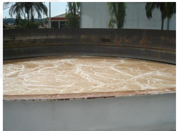
FOTO 04. Tanque de Aeração da ETE
