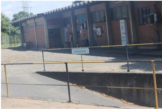
Foto 8: Tanque de decantação da drenagem pluvial
