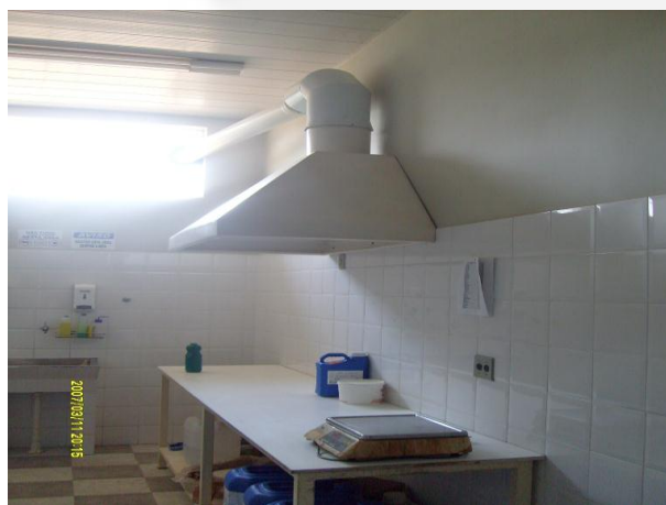
Foto 03. Sistema de Exaustor
