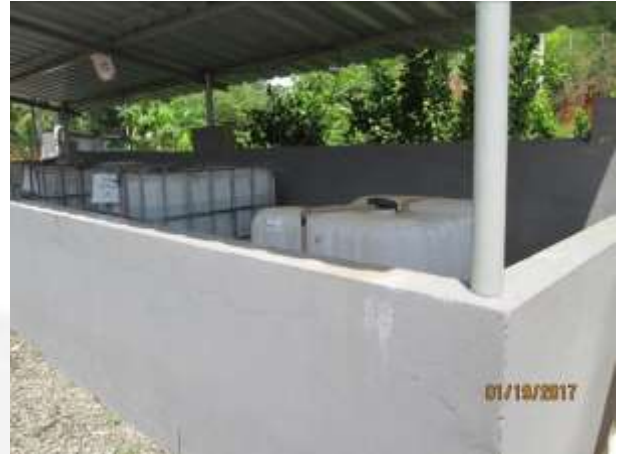
Fig. – Bacia de contenção produtos químicos utilizados na ETEI.
