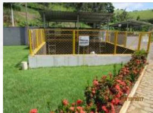
Fig. – Poço de recalque dos efluentes, recepção dos efluentes sanitários e acréscimo de produtos químicos no tratamento.
