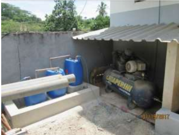
Fig. – Bacia de contenção, no sistema de separação de água e óleo de um dos compressores.
