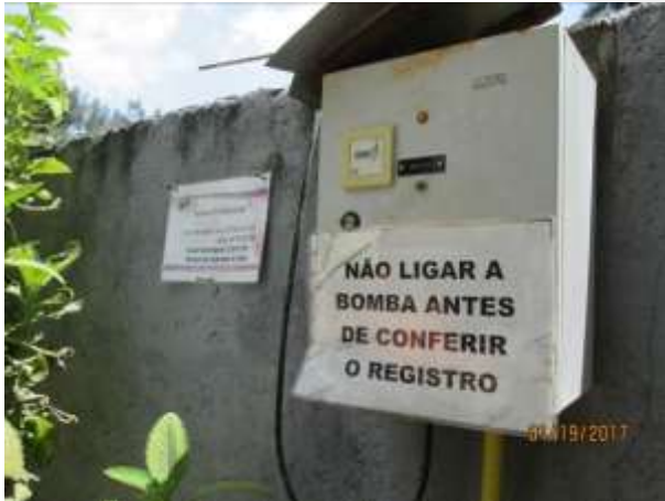
Fig. 13– Horímetro referentes ao poço já instalado.
