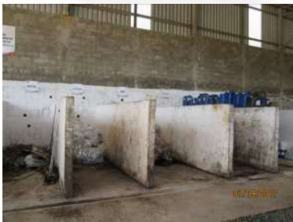
Fig. – Baias de resíduos recicláveis, todas com recolhedor de material líquido que possa escorrer.
