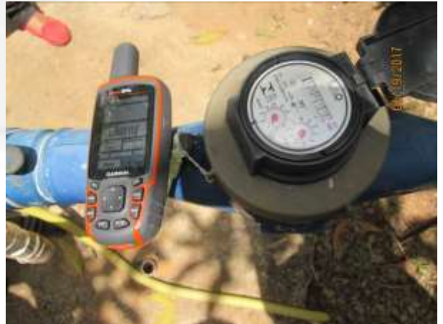
Fig. 14– Hidrômetro instalados no poço.
