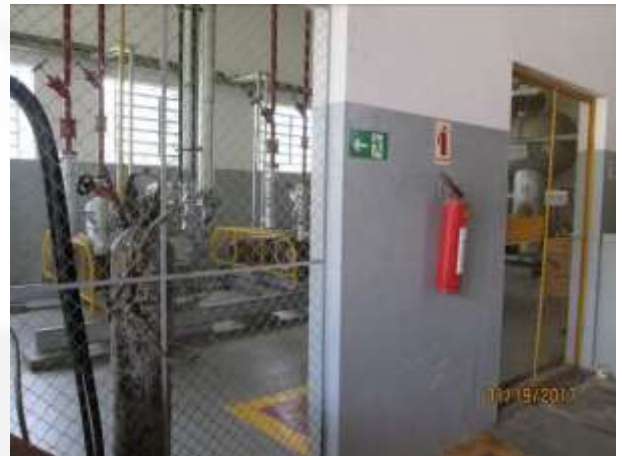
Fig.10 – Compressores de amônia com coleta da purga em tambores.
