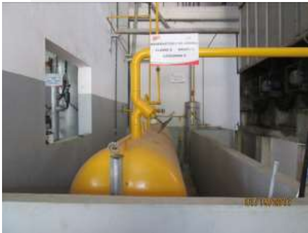
Fig.9 – Sistema de armazenamento de amônia com torre de resfriamento, com bacia de contenção e localizado em área externa.
