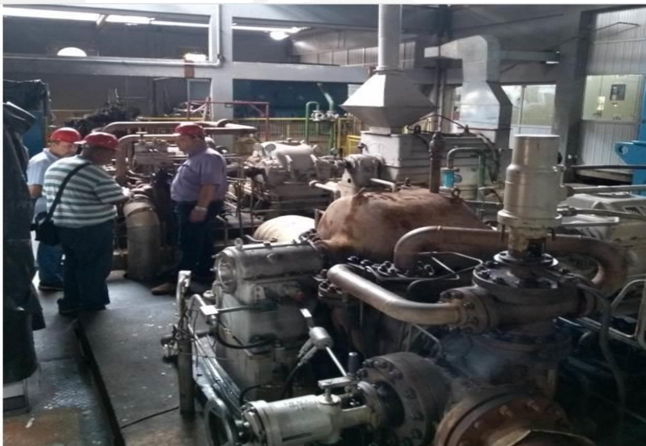
Figura 6: Vista interna da casa das turbinas.
