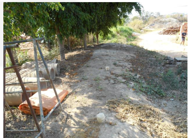
Foto 04. Fossa, filtro e sumidouro
