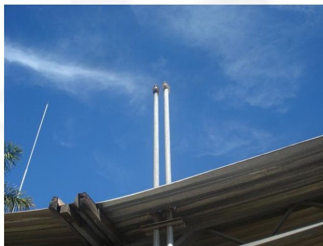
Válvulas de Contenção de Vapores Posto do Escritório Central – Vale Tapira
