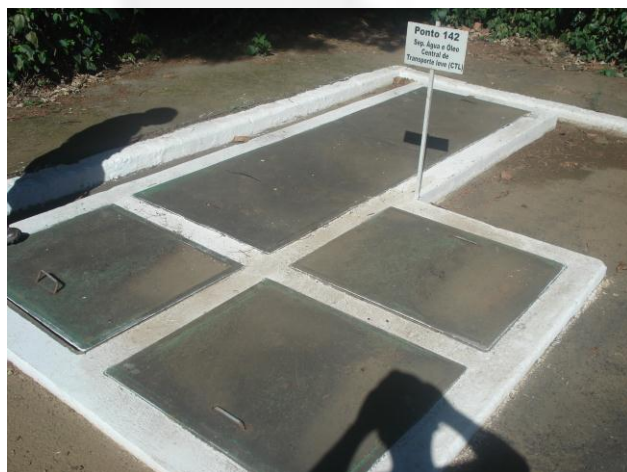
Caixa Separadora de Água e Óleo – SAO – Posto do Escritório Central
