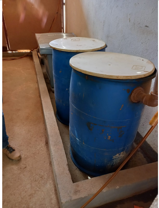
Foto 06: Bombonas da Caixa SAO da sala de compressores.
