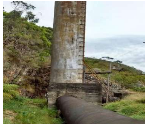
Figura 06: Chaminé de equilíbrio e tubulação adutora Fonte: PCA/RCA, 2015
