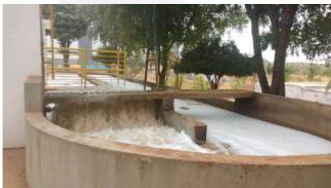
Foto 3 – Estação de Tratamento de efluentes
