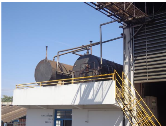
Foto 04. Armazenamento de óleo para caldeira.
