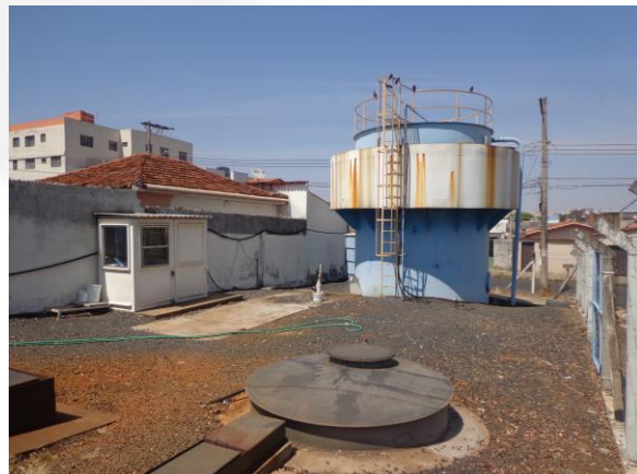
Foto 02. Vista da ETE.
