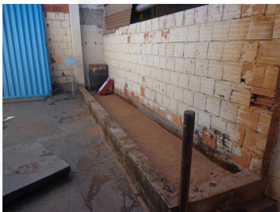
Foto 04. Armazenamento de óleo ou embalagens vazias com resíduos.
