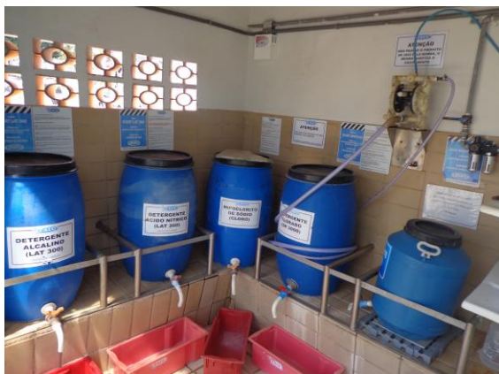
Foto 03. Armazenamento de produtos químicos para limpeza.
