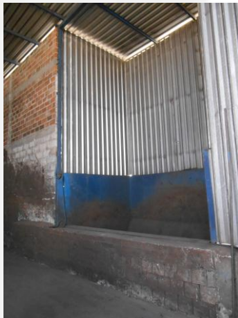
Figura 07: Estrutura situada no interior do galpão de armazenamento dos resíduos siderúrgicos, que direciona os resíduos diretamente à linha de produção.
