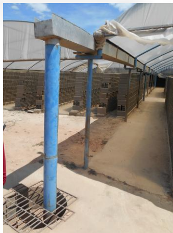
Figura 03: Canaletas – drenagem pluvial
