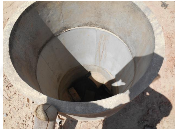
Figura 02: Caixa de sedimentação – drenagem pluvial
