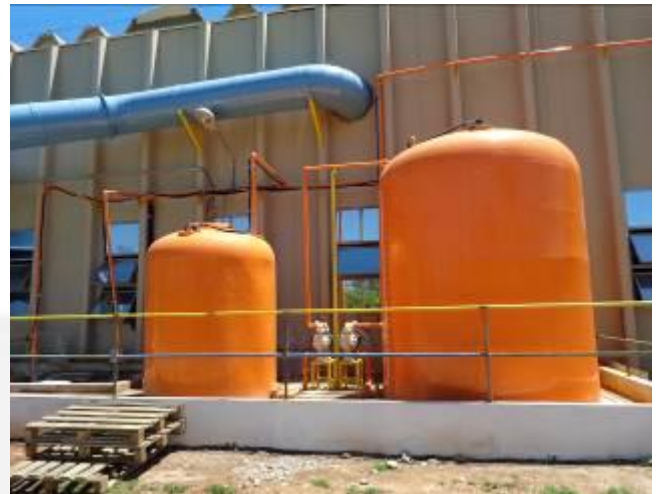
Foto 06: Tanques de efluentes
