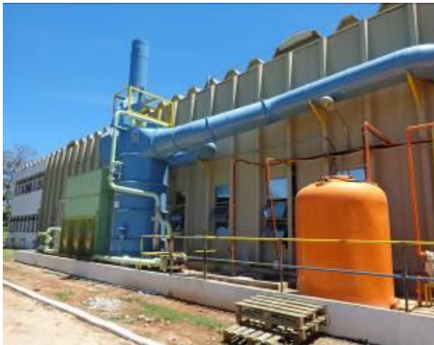
Foto 05: Lavador de Gases
