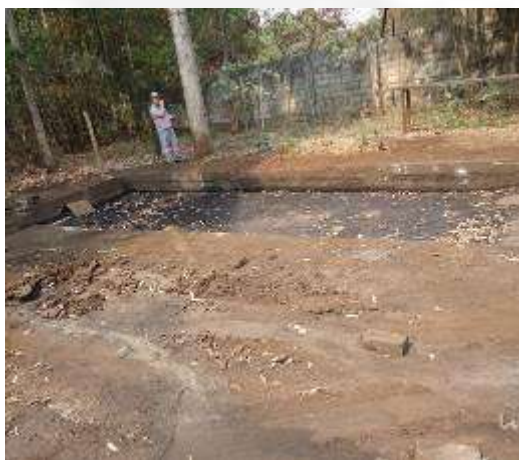
Foto 11. Tanque de decantação de efluentes pluviais assoreado.
