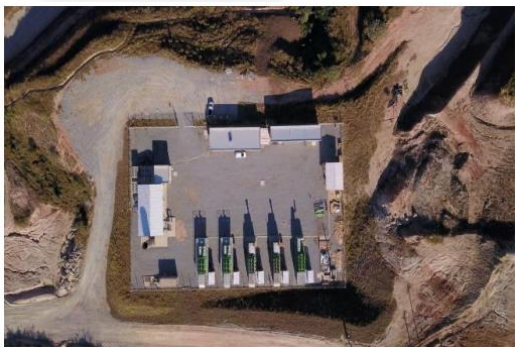
Foto 29. Usina de biogás - ASJA
