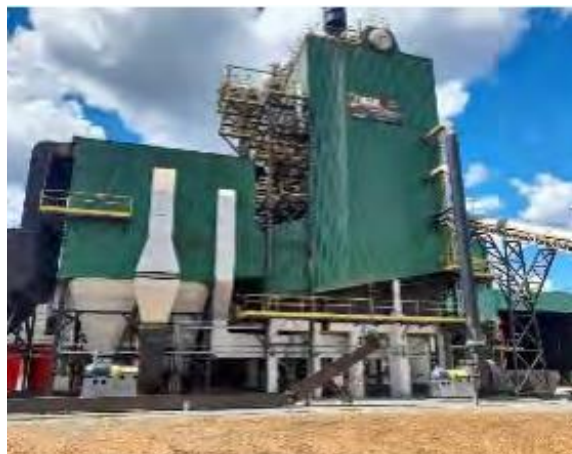
Foto 02. Caldeira e Cogeração de energia termelétrica
