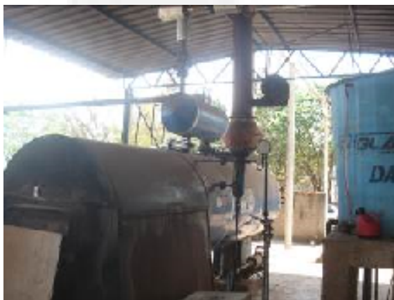
Foto 03. Caldeira para geração de vapor
