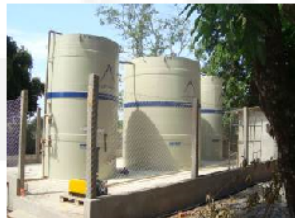
Foto 04. Estação de Tratamento de Efluentes
