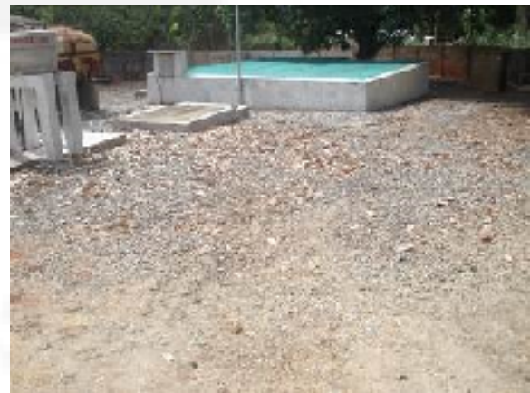
Foto 02. Tanque de equalização da ETE
