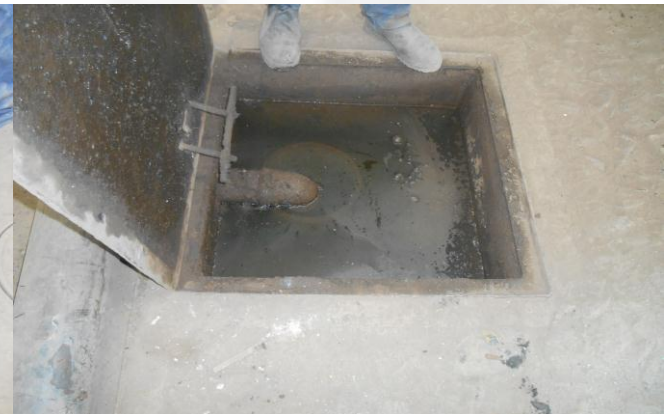
Foto 03: Canaletas ligadas à caixa SAO
