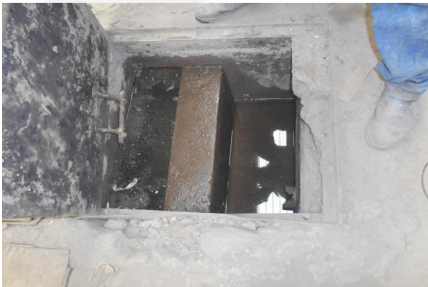
Foto 03: Caixa de sedimentação
