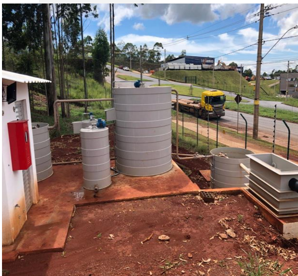
Foto 03. Estação de tratamento de efluentes líquidos industriais.
