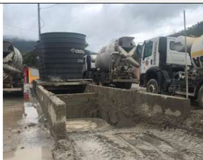
Foto 09. Sistema de decantação – Bate lastro.
