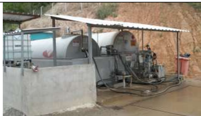
Foto 07. Ponto de abastecimento de combustíveis
