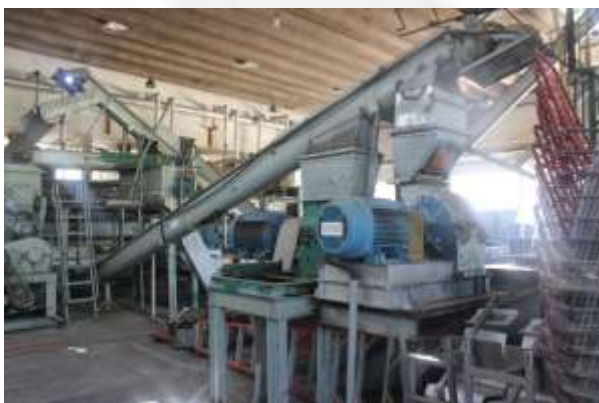
Foto 03. Equipamentos que serão revisados
