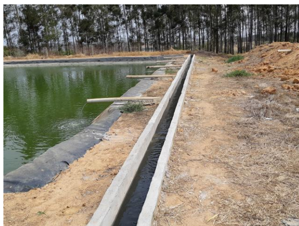
Figura 10. Lagoa de tratamento
