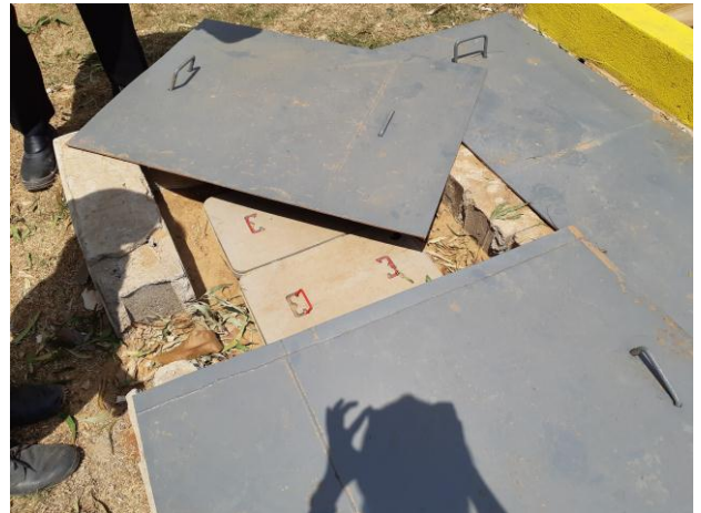
Figura 02. Caixa separadora de água e óleo
