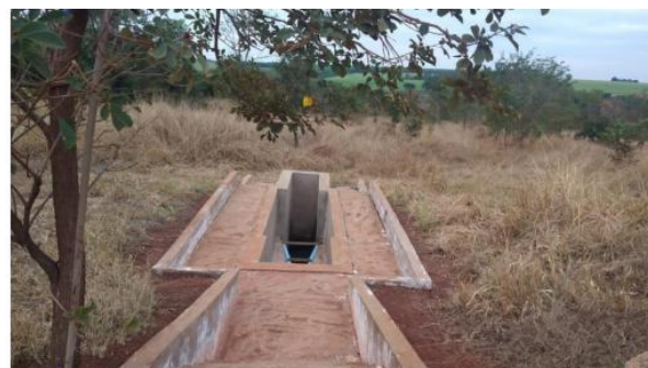
Foto 11. Medidor Calha Parshal do efluente tratado final.
