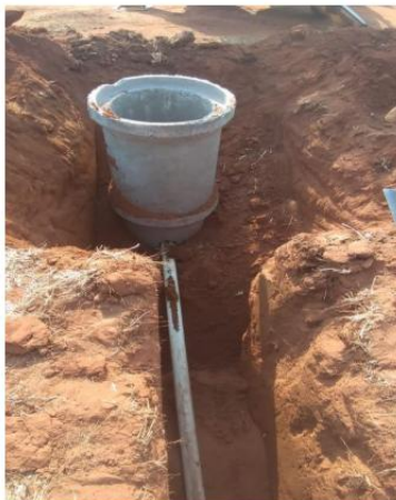
Imagem 03: Poço de Visita do líquido percolado.
