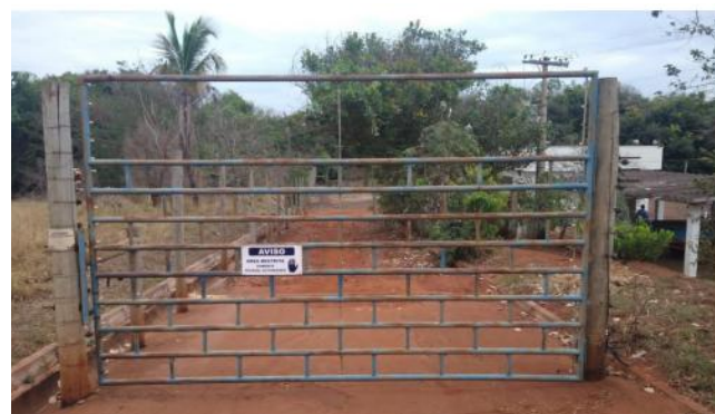
Foto 02. Portão na área interna de acesso a elevatória de esgoto final.
