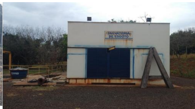
Foto 04. Elevatória final de esgoto.
