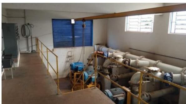
Foto 05. Casa de bombas da elevatória de esgoto.
