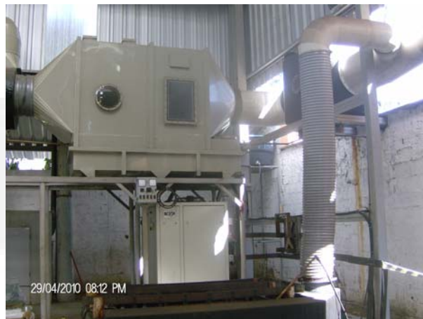
Foto 02. Lavador de gases e sistema de exaustão do tanque de cromação
