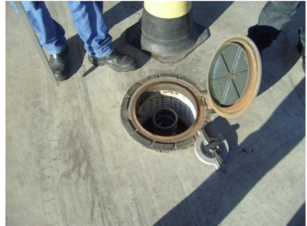
Foto 06. Caixa SUMP na boca do tanque
