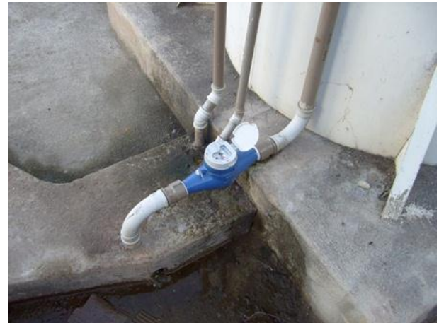
Foto 08. Hidrômetro instalado na saída do poço tubular
