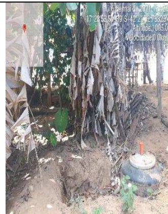
Figura 6. Biodigestor implantado na casa do caseiro
