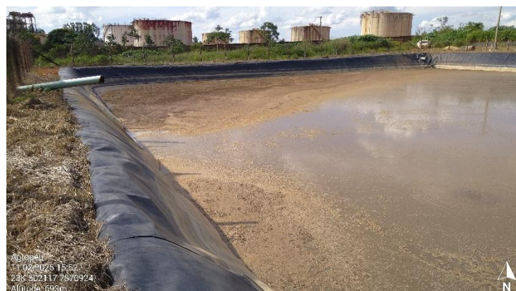
Foto 14: Tanque de vinhaça, impermeabilizado por manta PEAD de 2".
