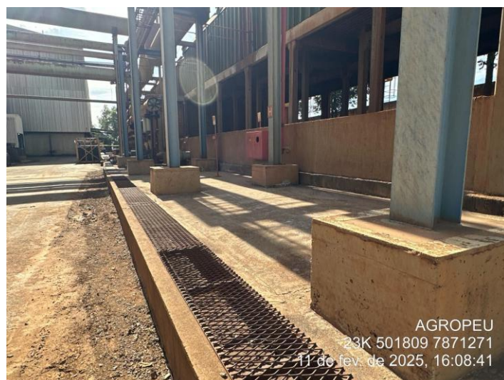
Foto 22: Canaletas no entorno da área onde estão instalados os resfriadores.
