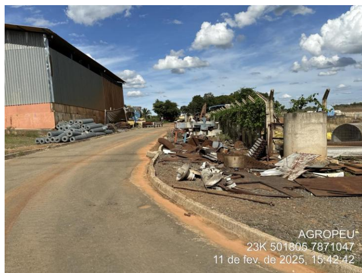
Foto 52: Próximos aos tanques de decantação também havia presença de sucatas.
