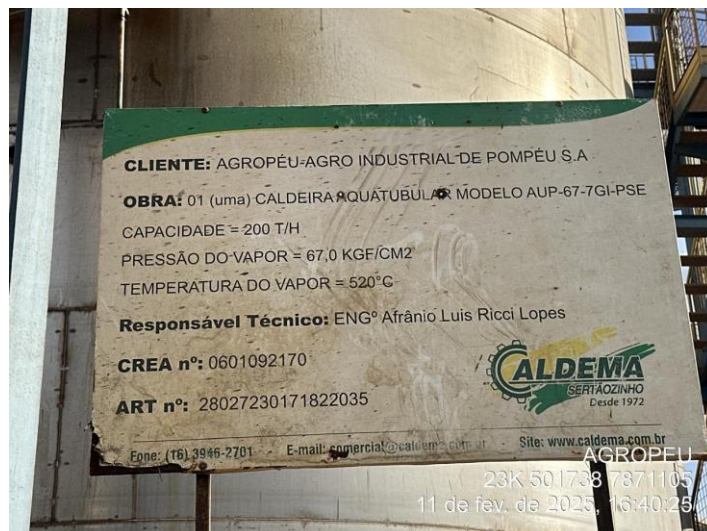
Foto 24: Placa informando sobre a operação da caldeira.
