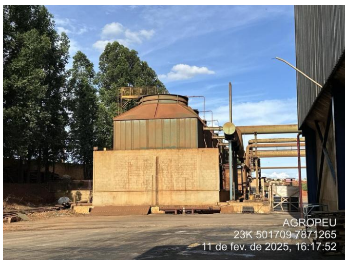
Foto 21: Resfriadores da usina.
