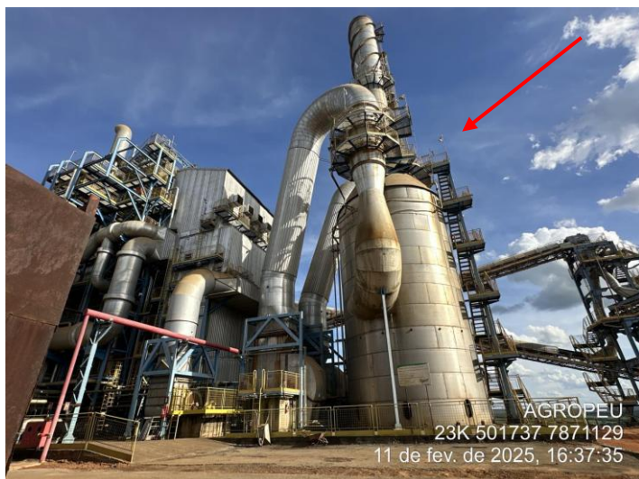
Foto 23: Estrutura da termoeletrica. Seta indicando a caldeiraria.
