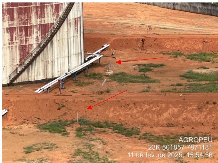
Foto 15: Tubulação que direciona a vinhaça até o tanque que a acumula. Setas vermelhas indicam os suspiros associados à tubulação, visto que se trata de efluente fermentado.
