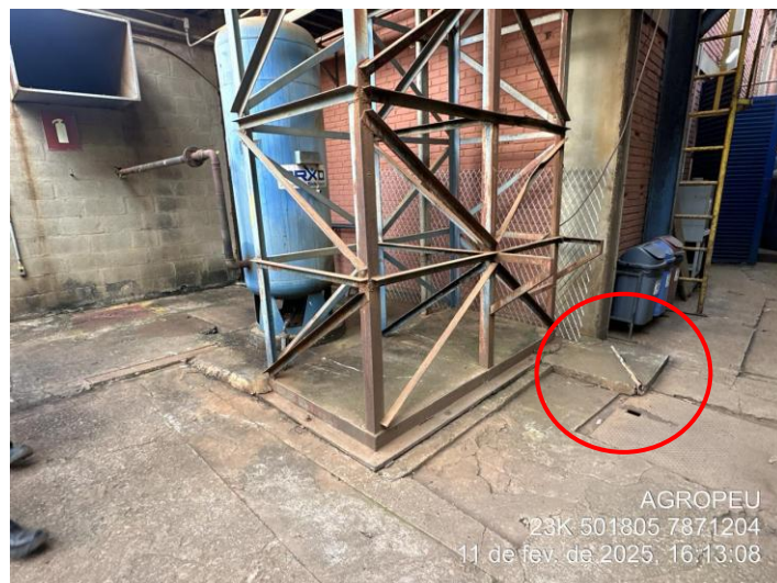
Foto 32: Tubulação que interliga a sala dos compressores à área externa para que os possíveis efluentes advindos dos equipamentos escoem para a caixa de passagem.
