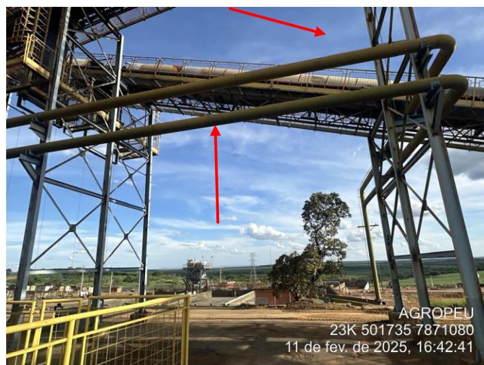
Foto 64: Tubulação que contempla sistema de recirculação de água.
