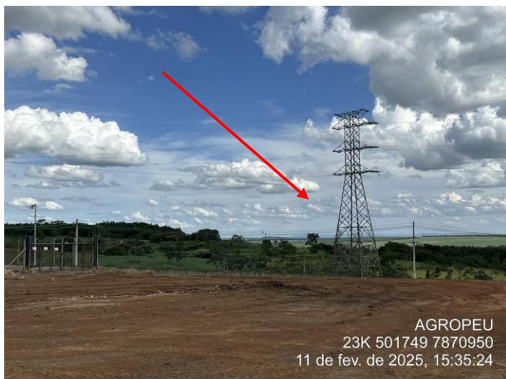
Foto 27: Torre de transmissão de energia elétrica.
