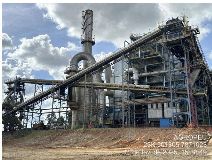
Foto 25: Outro ângulo da estrutura da termoeletrica. As turbinas e geradores ficam enclausurados.
