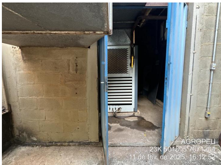
Foto 31: Área de armazenamento dos compressores.
