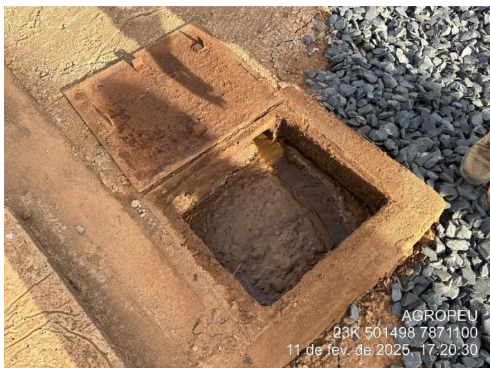
Foto 75: Caixa de passagem associada ao posto de combustível, com acúmulo de resíduos.
