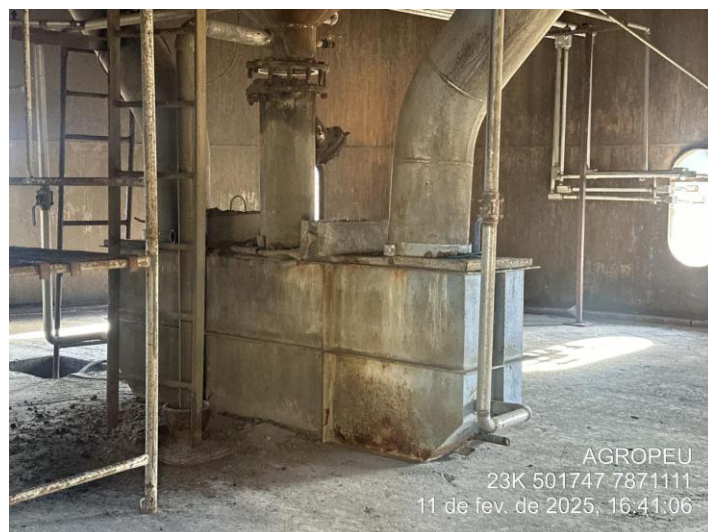
Foto 30: Tanque que armazena os particulados que decantam após ação do lavador de gases.
