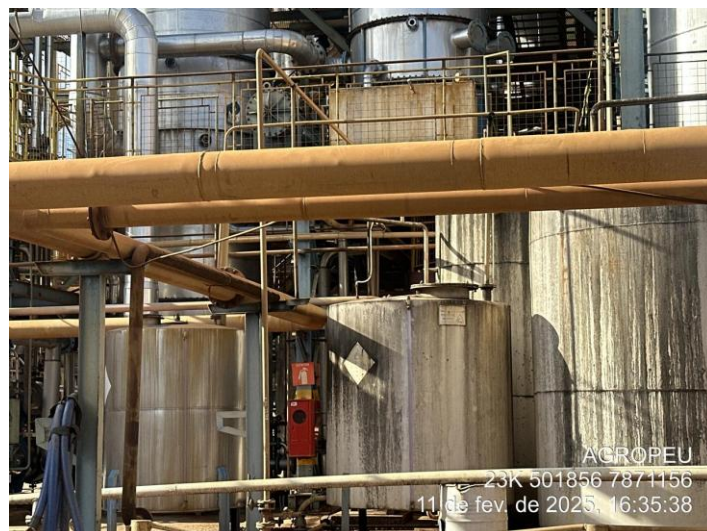
Foto 16: Seta vermelha indicando tanque de armazenamento do óleo fusel após ser gerado na destilaria.
