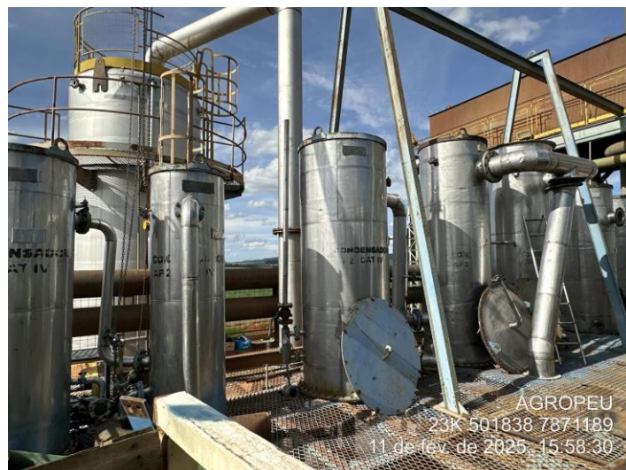
Foto 12: Condensadores que compõem a etapa da destilação do etanol.
