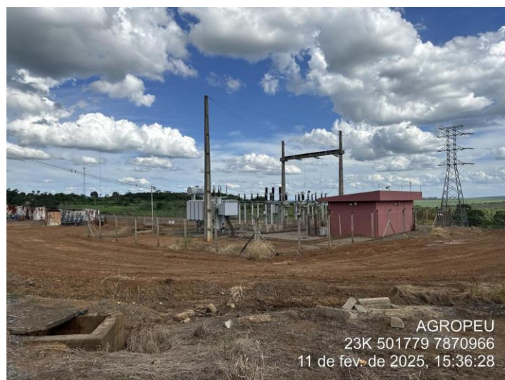
Foto 26: Subestação do empreendimento.
