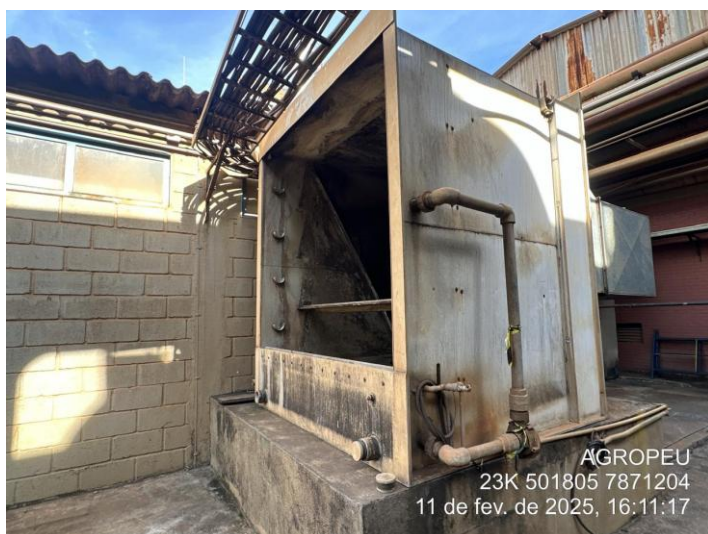
Foto 33: Vista do exaustor da caldeiraria.
