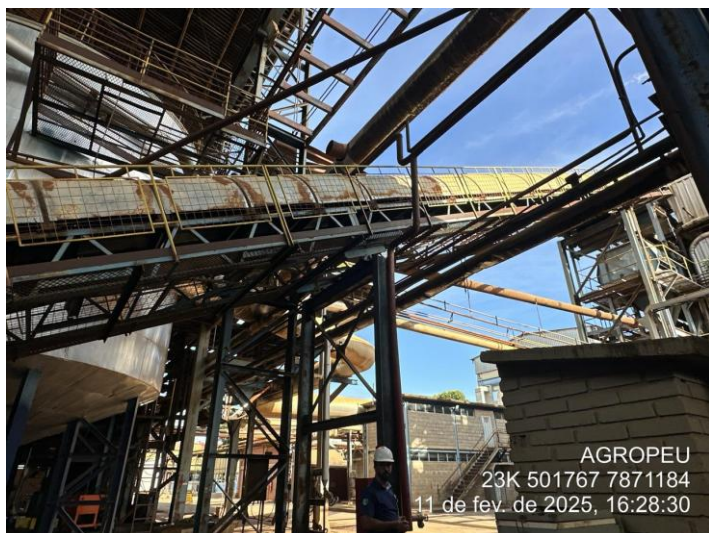
Foto 7: Esteira onde o bagaço da cana é conduzido para o pátio onde permanece armazenado até ser utilizado na caldeiraria.
