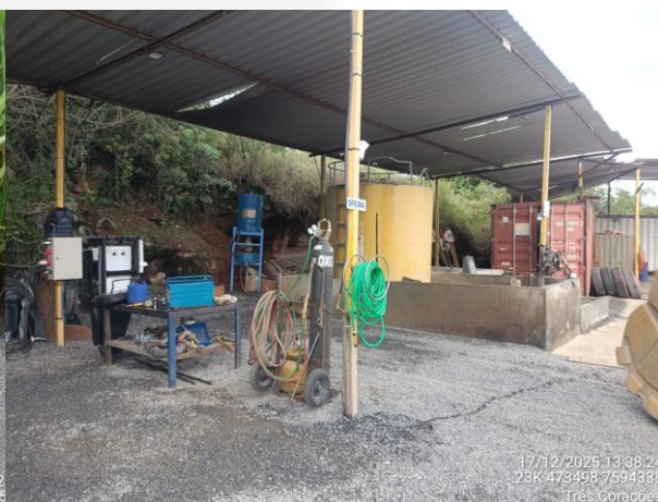
FOTO 6: Oficina sem piso impermeabilizado.
