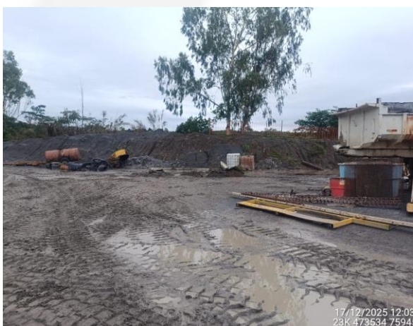
FOTO 3: Resíduos dispostos inadequadamente.
