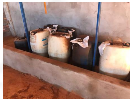
Figura 02. Bacia de contenção de produtos oleosos
