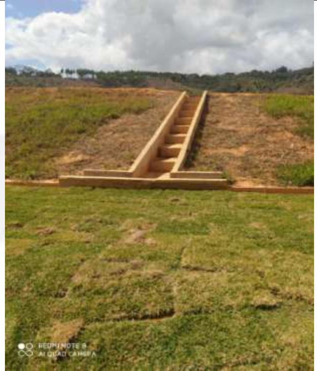
Foto 02: Sistema de drenagem em 01/09/2020
