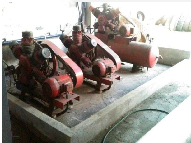
Foto 01. Compressores com bacia de contenção
