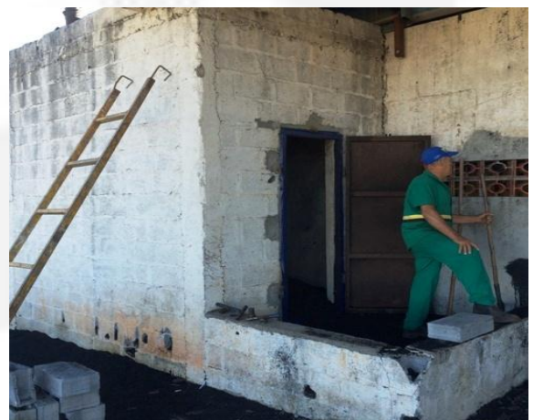
Foto 04. Depósito de pó de pneus
