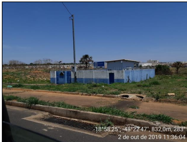
Figura 1: Estação elevatória de esgoto.
