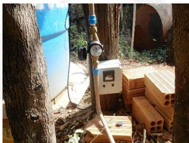
Foto 10. Hidrômetro e horímetro instalados no poço.
