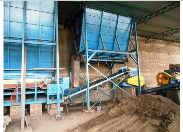
Foto 02. Silo e dosador de pó de balão
