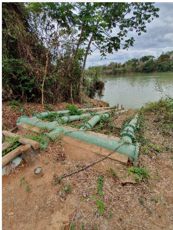
Foto 03. Captação no Rio Paracatu
