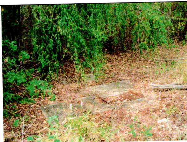
Foto 14: Sistema de tratamento de efluentes, com manutenção inadequada.
