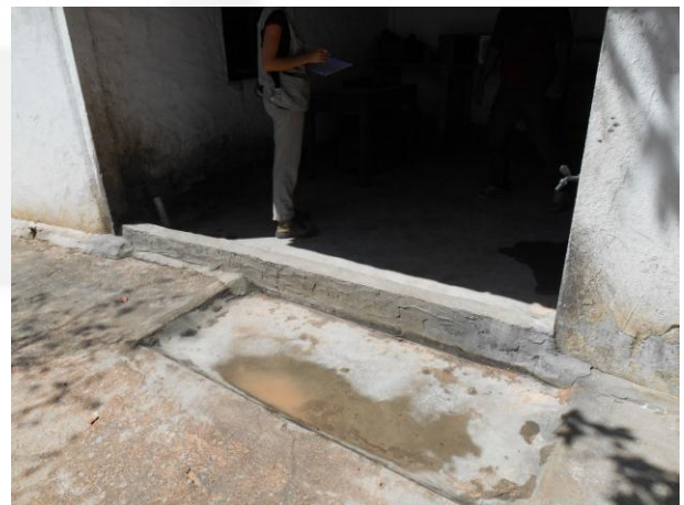
Foto 10. Galpão com lâmina d'água – sem uso no momento da vistoria.
