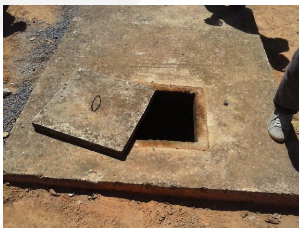
Foto 02. ETE efluentes sanitários.
