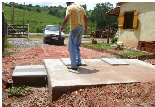
Foto 08. Sistema de Tratamento de Efluentes Sanitários – Fossa Séptica e Filtro Anaeróbio
