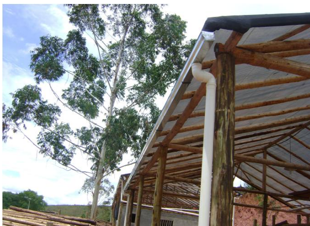
Foto 05. Sistema de captação de água pluvial.
