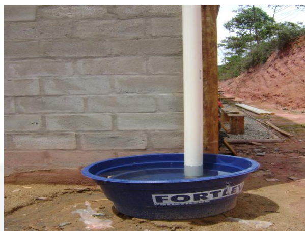
Foto 06. Sistema de captação de água pluvial.
