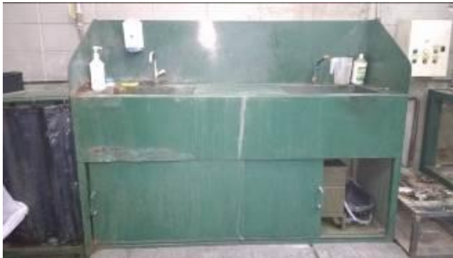
FOTO 7 - Pia para lavagem de peças (oficina) com coletor e filtro que segue para caixa SAO.
