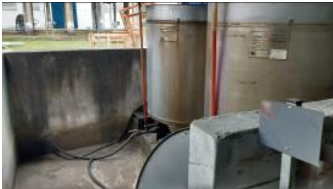
Foto 13: Tanques de Diesel Gerador com bacia de contenção.
