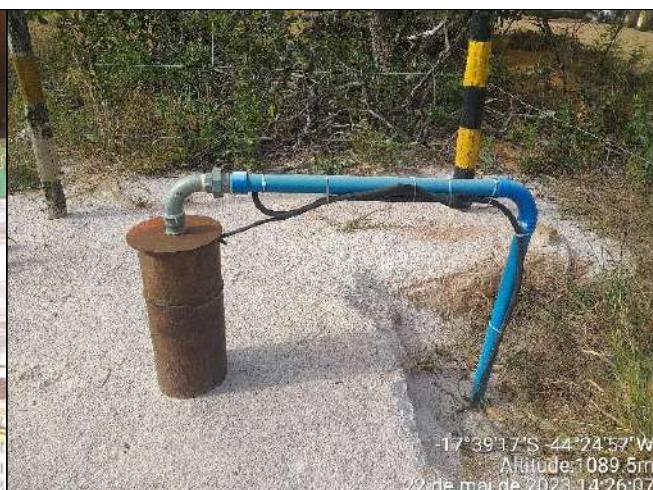
Foto 06. Captação em poço tubular
