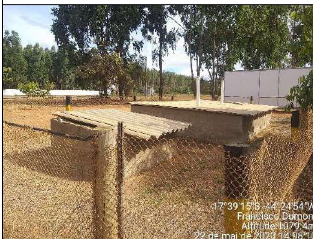
Foto 03. Fossa Séptica e Contêiners
