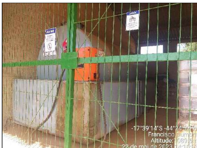
Foto 05. Tanque de abastecimento com dique
