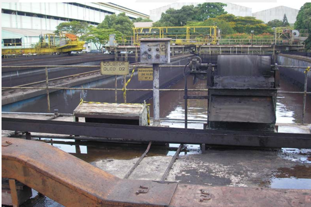
Foto 2: Vista frontal de um dos três decantadores da Bacia de Sedimentação
