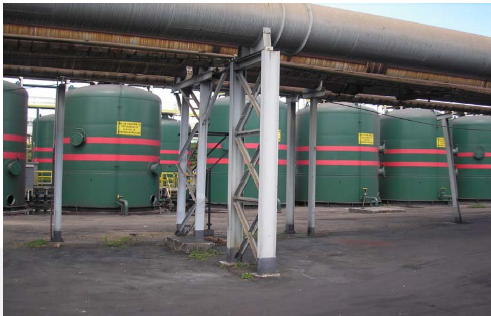
Foto 03: Conjunto dos 22 filtros pressurizados após a Bacia de Sedimentação. O material retido no leito filtrante forma a lama mineral.
