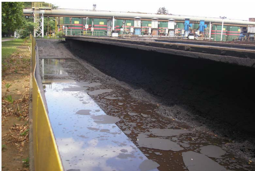
Foto 01: Canal lateral da Bacia de Sedimentação, onde são recolhidas as carepas sedimentadas.
