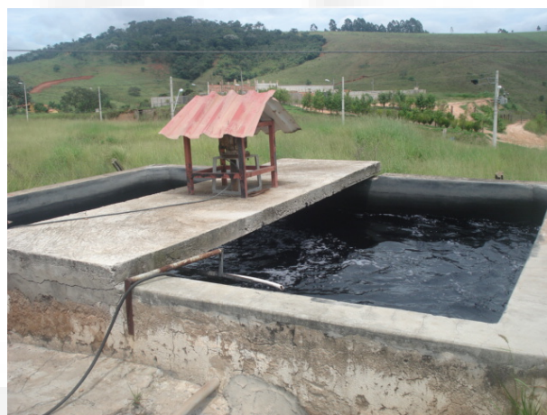
Foto 04. Sistema de tratamento de efluentes líquidos industriais.
