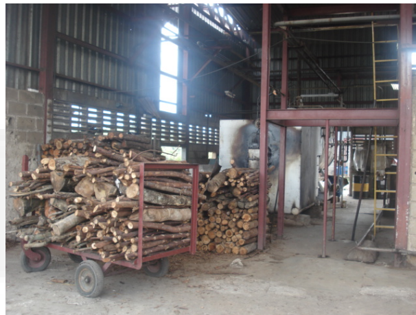
Foto 02. Galpão de geração de energia – caldeira.
