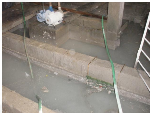
Foto 04. Baias do sistema de recirculação de água, onde é retirada a lama residual.
