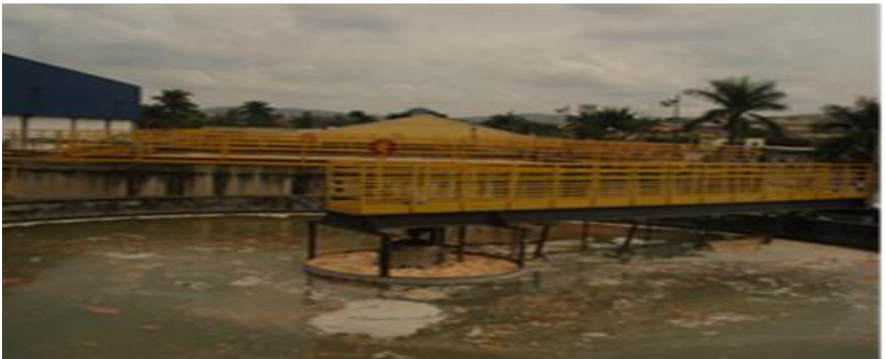
Foto 08 – Visão da ETE em detalhe decantador de lodo
