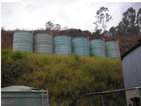
Foto 03. Armazenamento de água.
