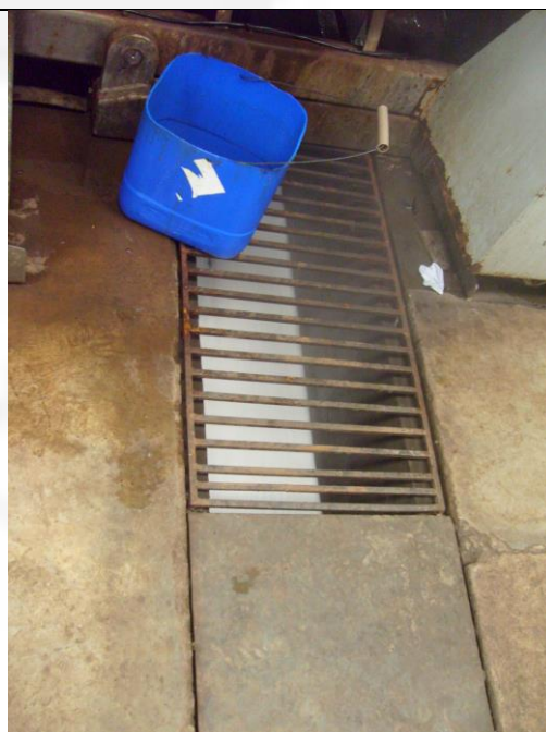
Foto 2: Despejo de efluentes da lavanderia para a ETEI
