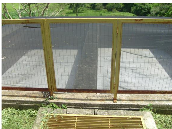
Foto 3: Estação de tratamento de efluentes industriais - tra físico-químico
