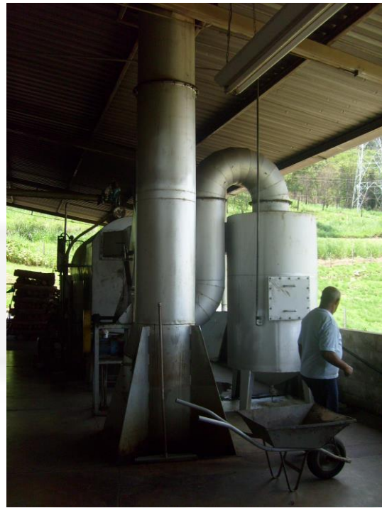
Foto 6: Lavador de gases da caldeira.
