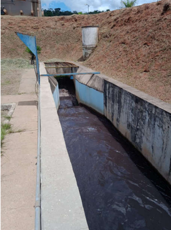
Foto 01: Medidor de vazão, calha Parshall.
