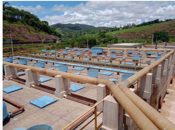
Foto 06: 4 novos reatores anaeróbios de fluxo ascendente e manta de lodo (UASB).
