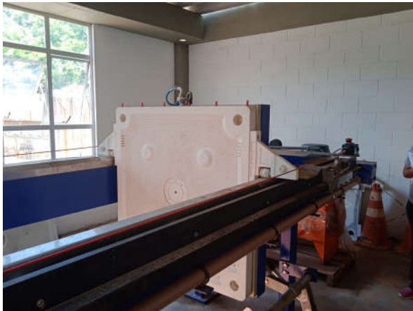
Foto 05: Filtro prensa novo já instalado para a desidratação mecânica do lodo biológico.
