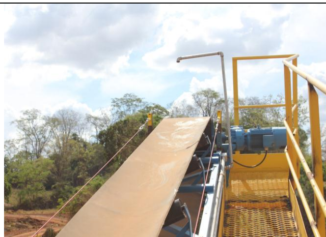
Foto 02: Sistema de aspersão implantado na ponta das correias transportadoras
