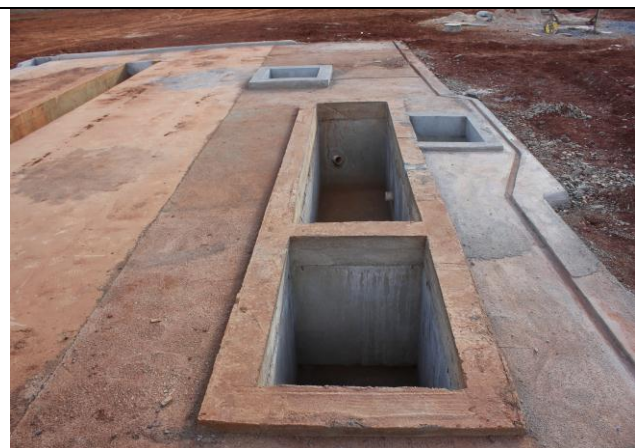
Foto 03: caixa separadora de água e óleo.
