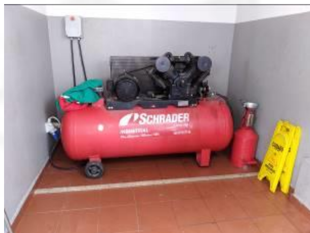
Isolamento na área do compressor
