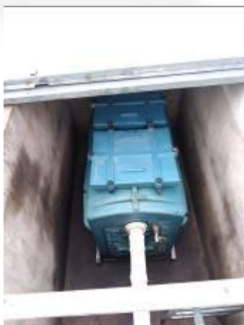
Caixa separadora de água e óleo
