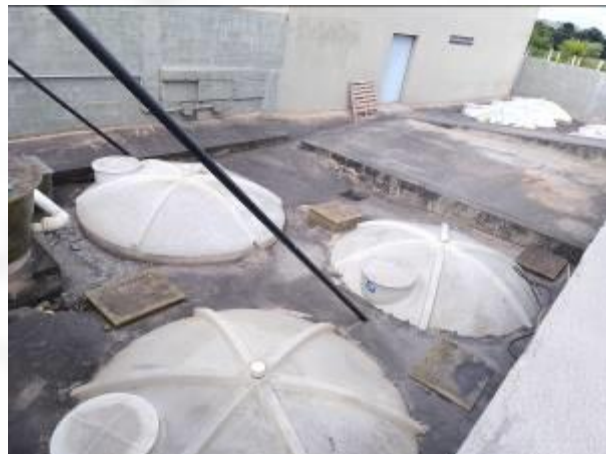
Estação de tratamento de efluentes
