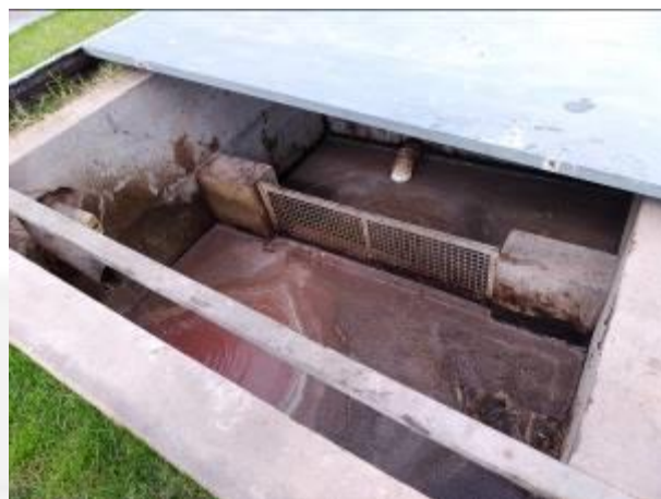
Caixa de gordura do restaurante
